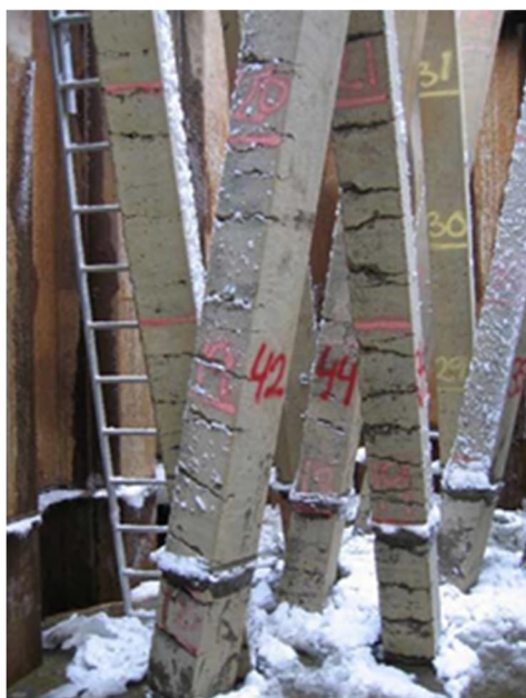
Figur 6.26 Typiska skador på betongpålar, orsakade av vattensprängning.
