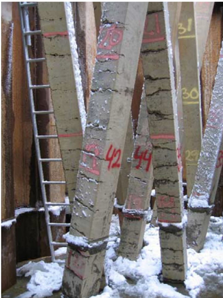
Figur 3.17 Typiska skador på betongpålar slagna genom fritt vatten orsakade av hydraulisk utmattning.
