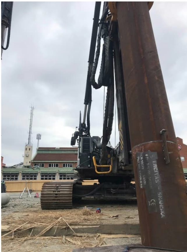
Figur 1.14 Överst: Installation av slagen stålörspåle från pålbrygga. Underst: Installation av slagen stålörspåle vid CityGate.
